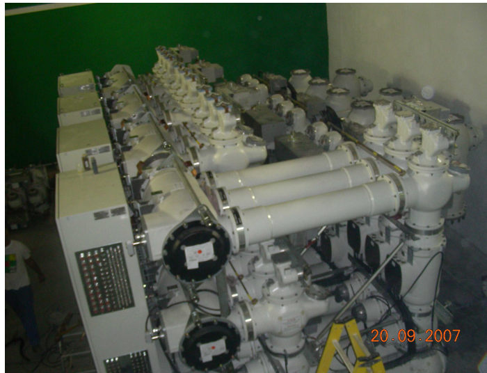
Figura 7. Subestación GIS La Cereal 220kV, vista de la parte superior.
