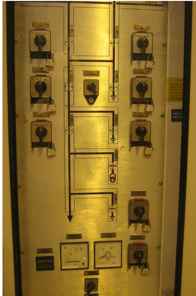
Figura 29. Armario de control local de posición de línea de una subestación GIS.
