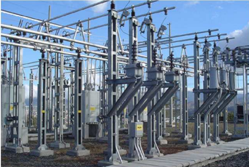
Figura 5. Ejemplo de embarrado de una subestación eléctrica.
