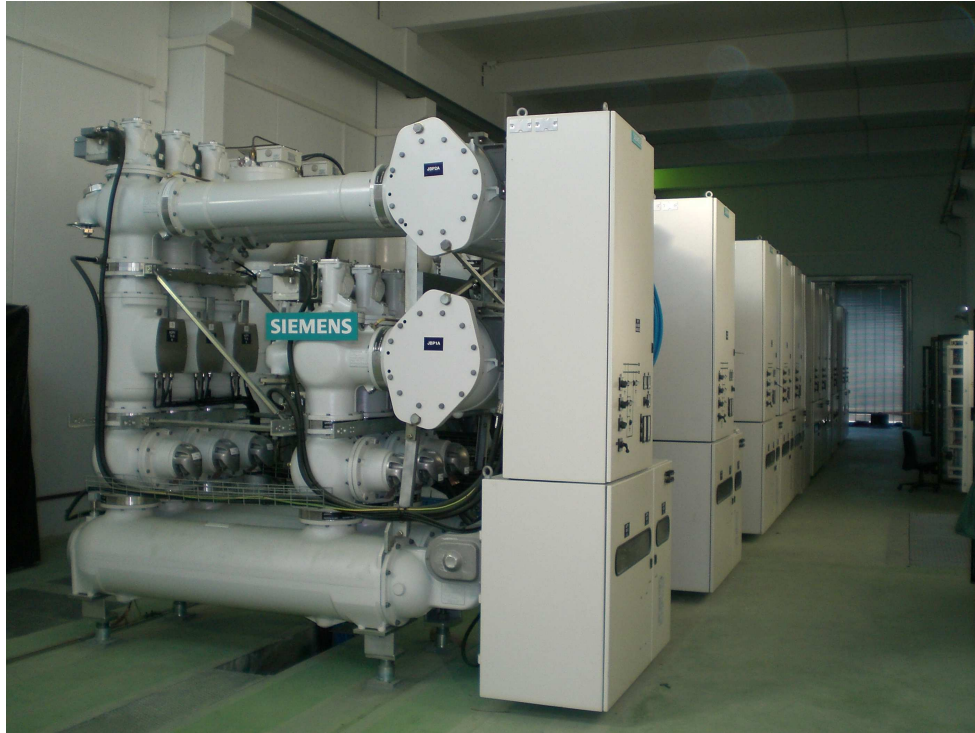
Figura 4. Subestación GIS e interior.
