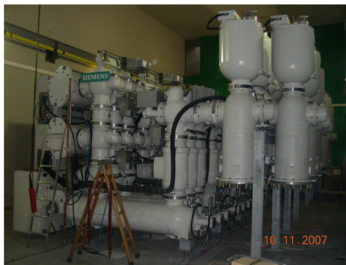
Figura 6. Subestación GIS La Cereal 220kV, vista lateral.
