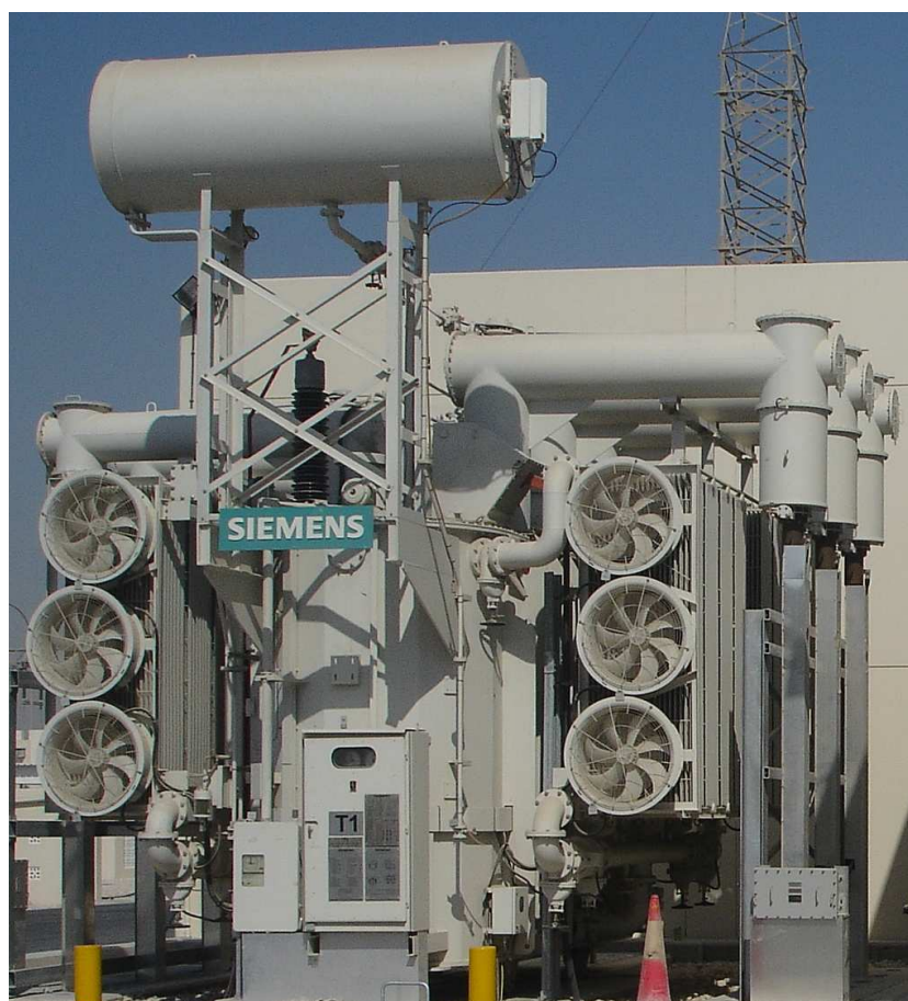
Figura 30. Transformador de potencia.
